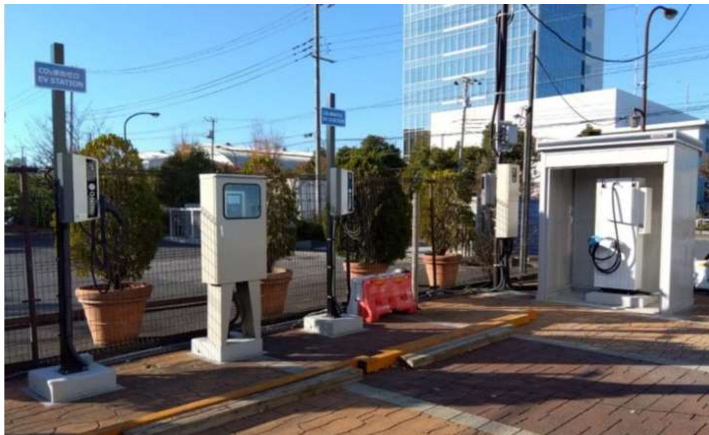
塩害対策用設置事例
